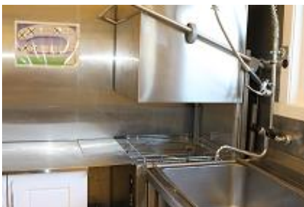
Brukerinfo henger på veggen ved oppvaskmaskinen.
